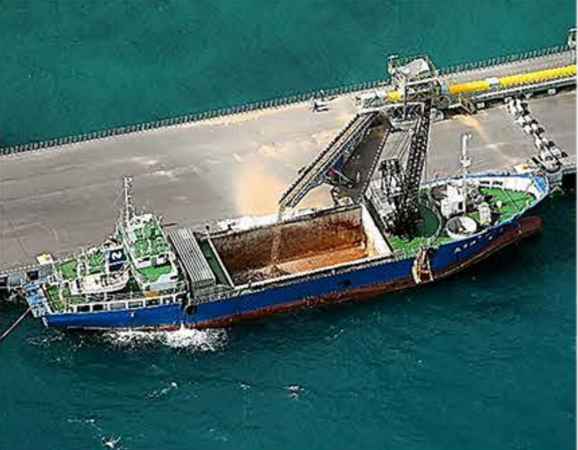
辺野古沿岸部に投入する土砂の搬出に使う橋脚。輸送船に土砂を載せる作業が進んでいた。3日午後、沖縄県名護市、本社機から、伊藤進之介撮影
