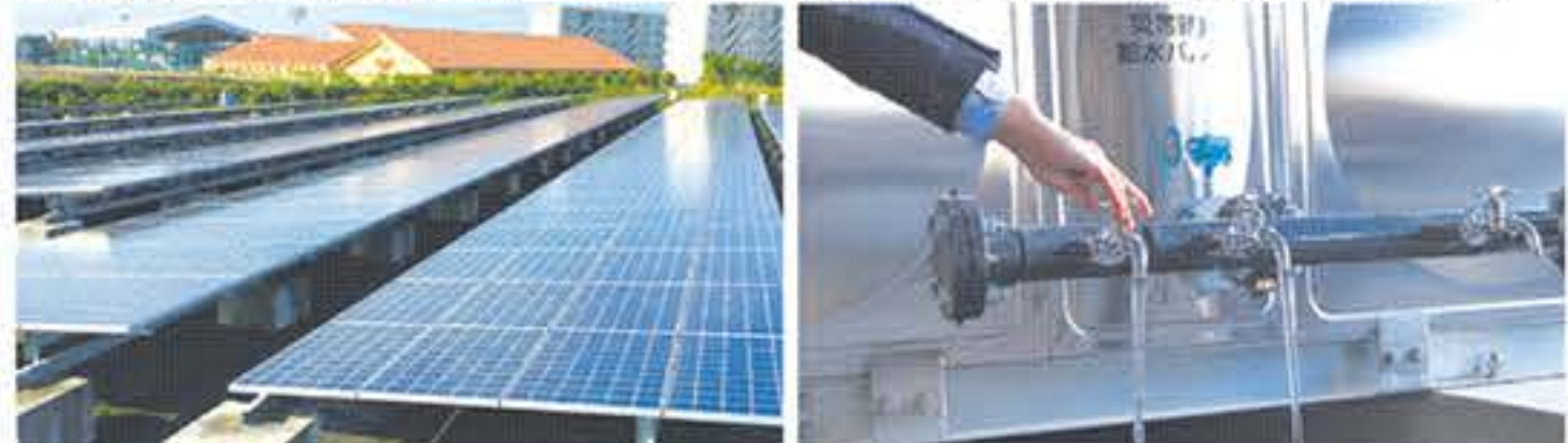
津波を想定した屋上の非常用電源
